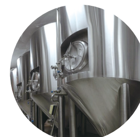
CIP洗剤移送・循環ライン
